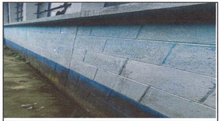
Foto 4: Pintura en muros exteriores e interiores descolorido necesario pintarlas
