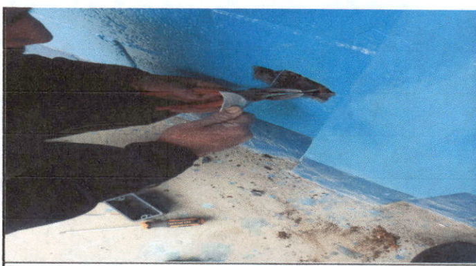
Foto 6: Cambiando tomacorriente en mal estado
