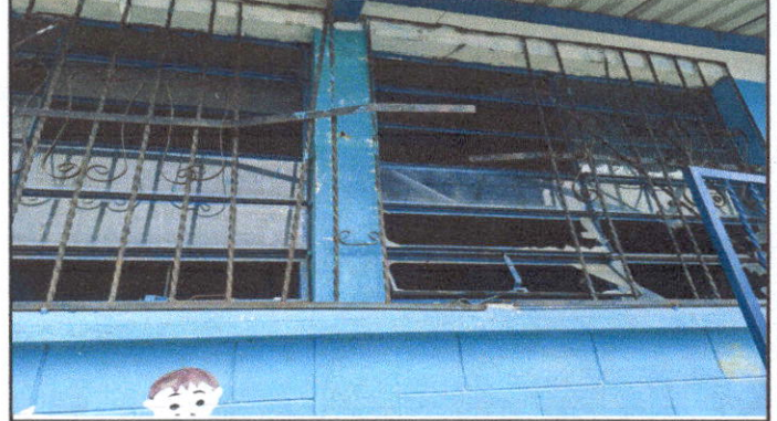
Foto 2: Vidrios quebrados necesarios cambiarlos. Balcones en mal estado necesario cambiarlos por balcones de metal
