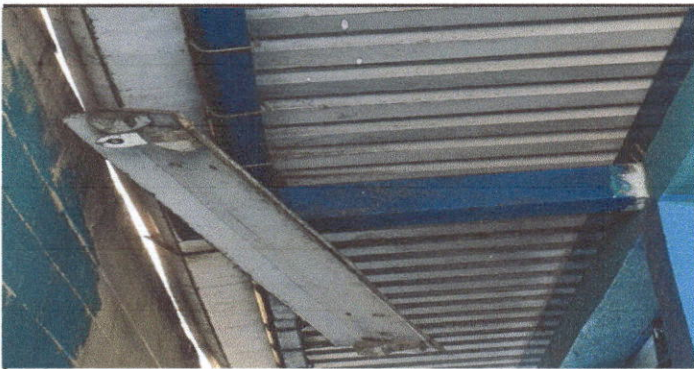
Foto 5: Sistema electrico: No hay Iluminación.
