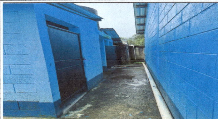
Foto1: Se dio mantenimiento a estructura (lijado, cambio de tubo, cepillado sujecion, aplicación de pintura puertas de baños) 98 x 180 mts2
