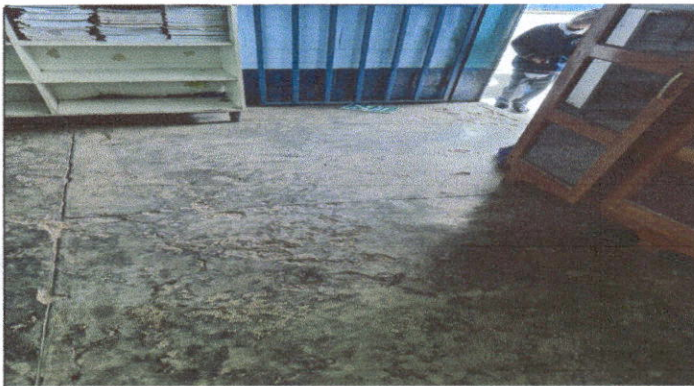
Foto 3: Piso de aula en mal estado necesario mejorarlo de 5 aulas
